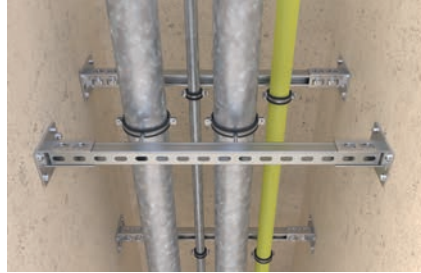
Rohrbefestigung im Fluchtbereich
