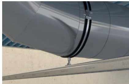
Tragekonstruktion für Lüftungsanlagen
