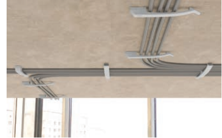
Befestigung von Kabelsträngen
