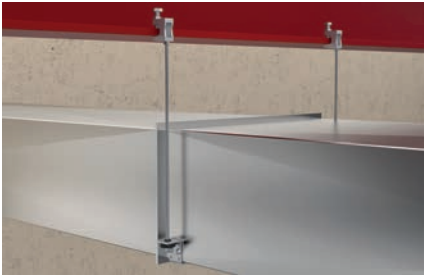
Lüftungskanal an Stahlträger mit Trägerklammer
