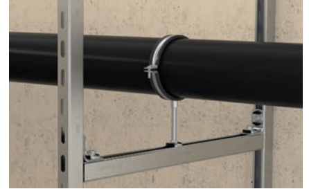
Rohrbefestigung auf Rahmenkonstruktion
