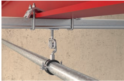
Schiene an Stahlträger
