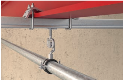
Schiene an Stahlträger
