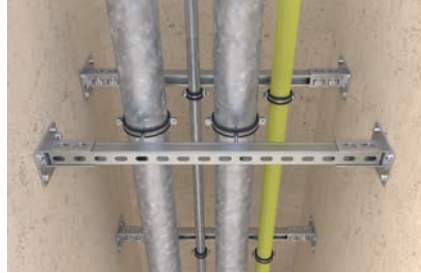
Rohrbefestigung im Fluchtbereich
