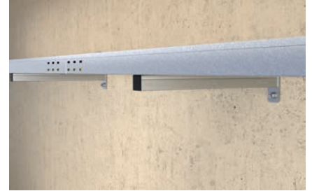
Kabeltrasse auf Auslegerkonsolen
