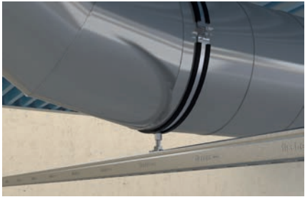
Tragekonstruktion für Lüftungsanlagen
