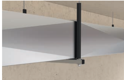
Lüftungskanalbefestigung mit Montageschiene
