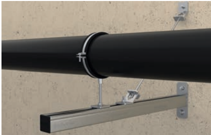
Schweres Abwasserrohr stehend auf Konsole
