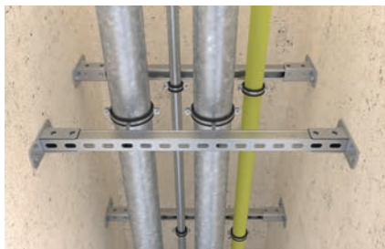
Rohrbefestigung im Fluchtbereich
