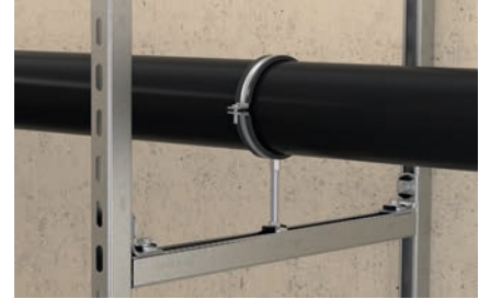
Rohrbefestigung auf Rahmenkonstruktion
