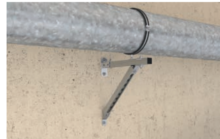
Lüftungsrohr auf Wandkonsole
