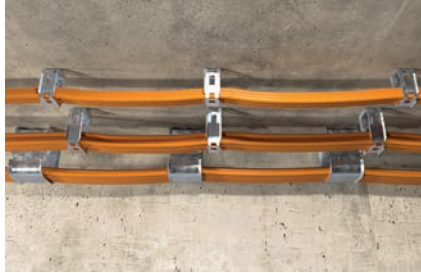
Kabelbefestigung an der Decke
