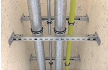
Rohrbefestigung im Fluchtbereich
