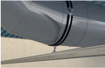
Tragekonstruktion für Lüftungsanlagen
