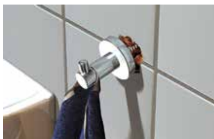
Reparatur ausgerissener Handtuchhalter
