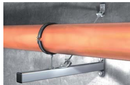
Schweres Abwasserrohr stehend auf Konsole
