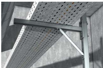
Kabelpritsche auf Konsolenkonstruktion
