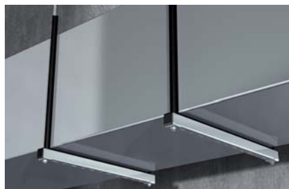
Luftkanal mit Schalldämmung auf Montage- schiene
