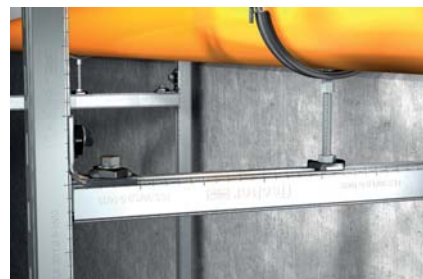
Rohrbefestigung auf Rahmenkonstruktion
