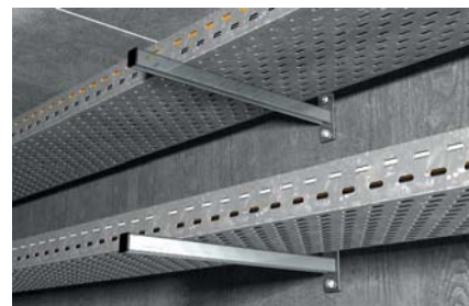
Kabeltrasse auf Auslegerkonsolen
