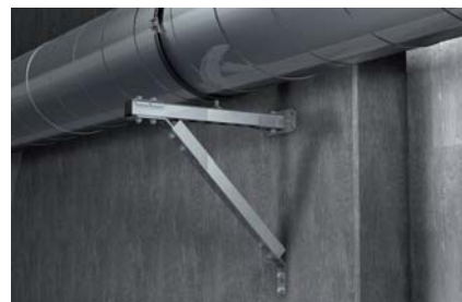
Lüftungsrohr auf Wandkonsole
