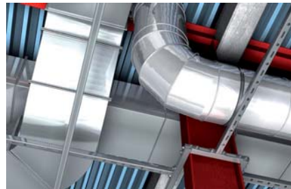
Tragekonstruktion für Lüftungsanlagen
