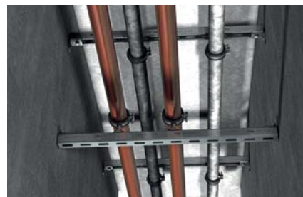
Rohrbefestigung im Flurbereich
