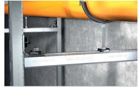
Rohrbefestigung auf Rahmenkonstruktion
