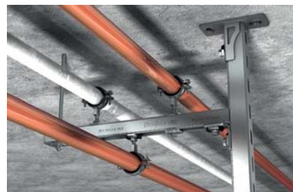
Konsolenkonstruktion mit Schienen
