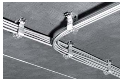
Befestigung von Kabelbündeln
