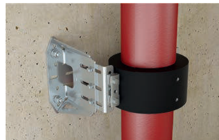
Medienleitungen mit thermischer Ausdehnung
