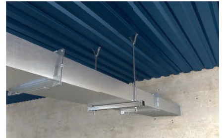
Lüftungskanal an Trapezblech
