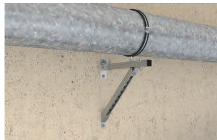
Lüftungsröhr auf Wandkonsole
