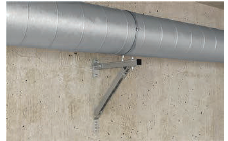
Lüftungsrrohr auf Wandkonsole
