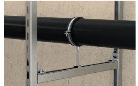
Rohrbefestigung auf Rahmenkonstruktion
