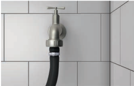
Auslaufventil mit Schlauch
