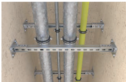
Rohrbefestigung im Fluchtbereich
