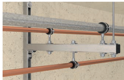
Konsolenkonstruktion mit Schienen
