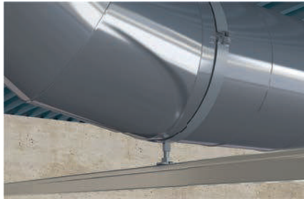
Tragekonstruktion für Lüftungsanlagen
