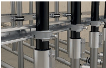
Befestigung von Medienleitung an FUS-Installationschiene
