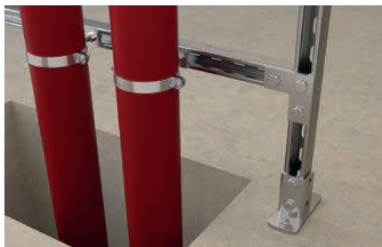
Abflussrohrbefestigung im Steigstrang
