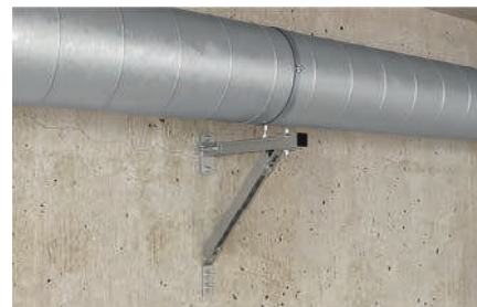
Lüftungsrohr auf Wandkonsole
