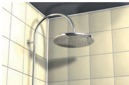
Verfugungen im Sanitärbereich
