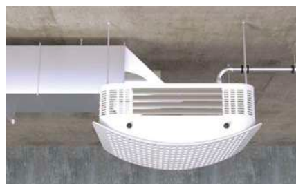
Lüftungs- und Heizungsanlagen
