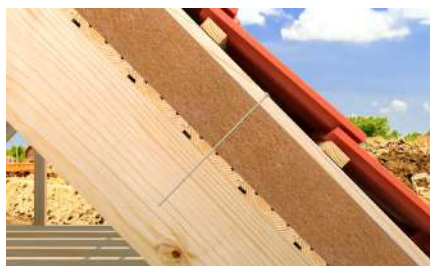
Nicht druckfeste Dämmstoffe in der Aufdachdämmung
