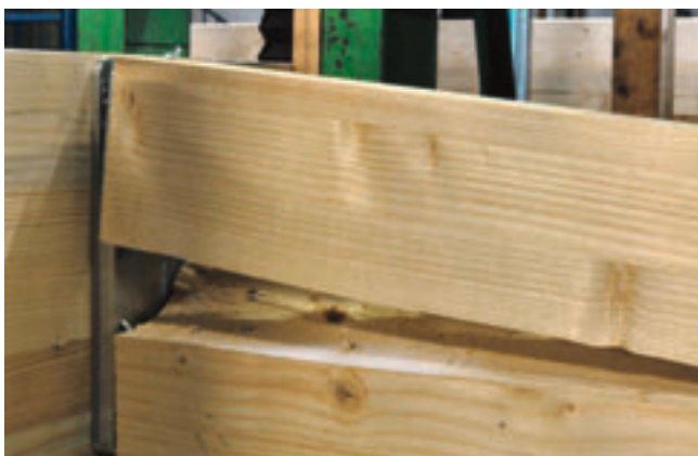
Versagensbild: Riss parallel zur Faser im Nebenträger und plastische Verformungen
