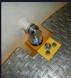
Abbildung 1 Installation auf der Azimutplattform einer laufenden Windkraftanlage. Die Original Nord-Lock Keilsicherungsscheiben an jeder Schraube helfen, Probleme durch Belastungen und Schwingungen zu vermeiden.
